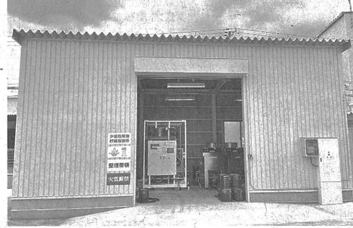
新設した設備のようす
